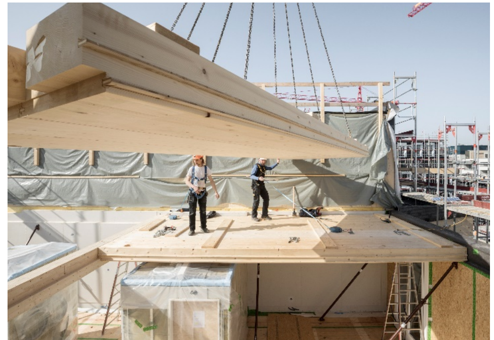
«Neustadt aus Holz sueËttil»: CO 2 -Speicher von 10.000 t CO 2 , weberbrunner architekten Foto: Beat Bühler
